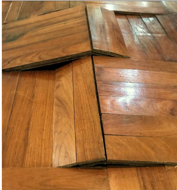
RAKENNUSTEN VAHINKOSELVITYKSET JA KORJAAMINEN
